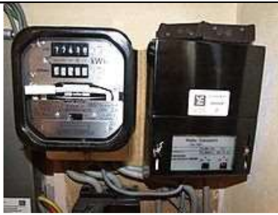
fig. 1: Analog Energy Meter
