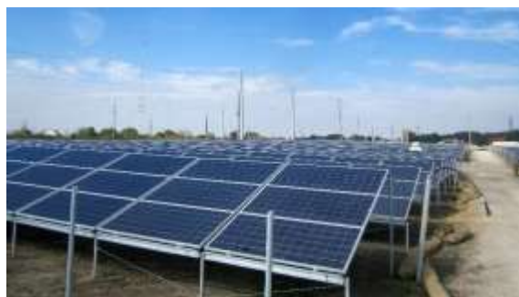
Fig: Solar panels
