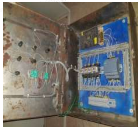
Fig. 1: Actual fire panel.
